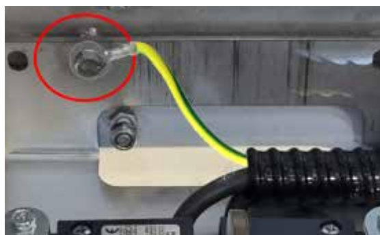
SAF-XN aardepunt ter hoogte van de eindcontacten
