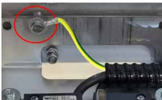
SAF-XN aardepunt ter hoogte van de eindcontacten
